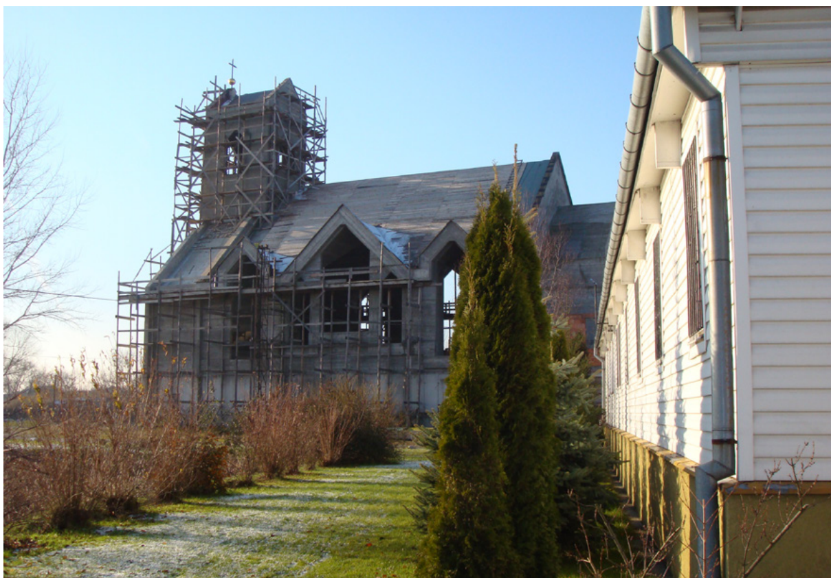
Stan budowy świątyni w 2007 r. Po prawej stronie widoczny fragment starej kaplicy, sprowadzonej z parafii na Bródnie, po lewej stronie, za krzakami, rozciąga się staw.
